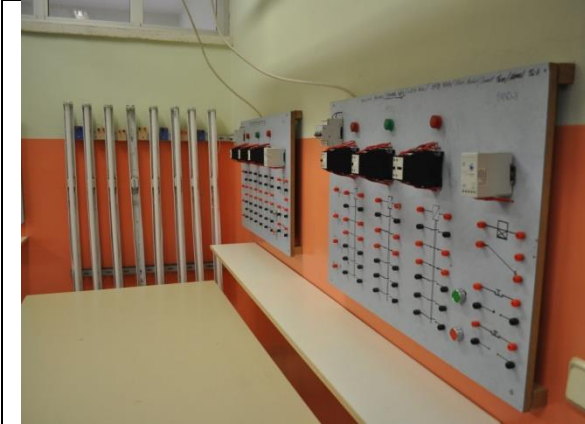
Deney Panoları Elektrik
